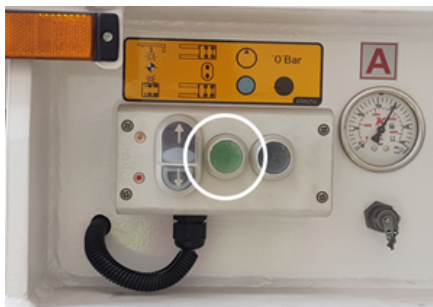
Bouton de démarrage de la pompe
