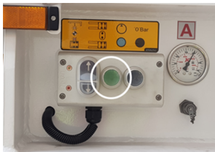
Bouton de démarrage de la pompe
