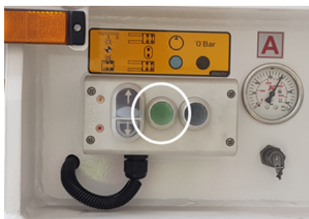
Bouton de démarrage de la pompe
