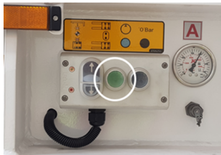
Bouton de démarrage de la pompe
