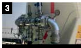
3 Linie sprężonego powietrza i odprowadzania powietrza Złącza i zawory Stal nierdzewna
