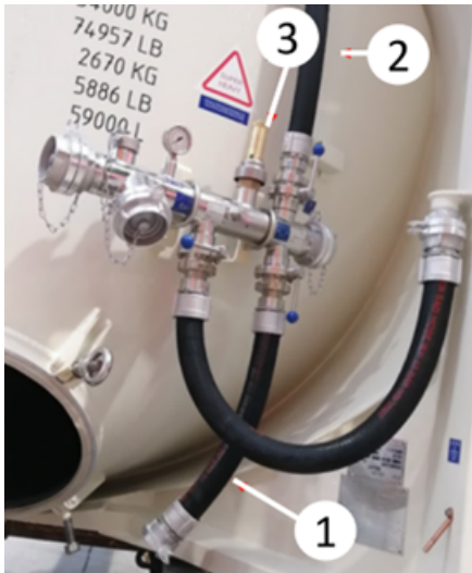
Batería de Mezcla de Aire
