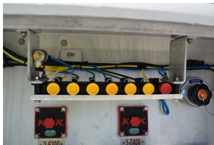
Bloque de control
