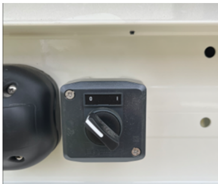
Interruptor de iluminación interior
