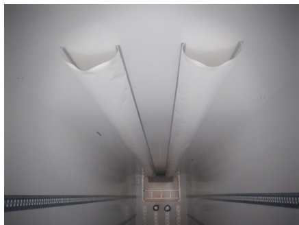
Conducto de ventilación de tipo tubular
