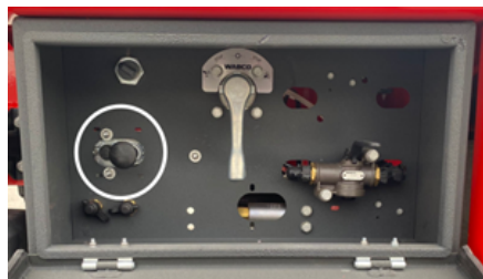
Botón de corcho de elevación del eje en el armario eléctrico
