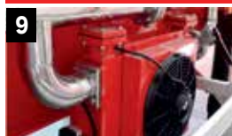
9 Enfriador de aire
