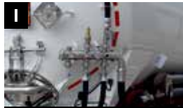
I Líneas de aireación de descarga
