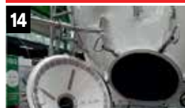
14 Aération du refoulement
