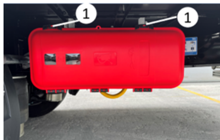
Ouverture de l'armoire à extincteurs
