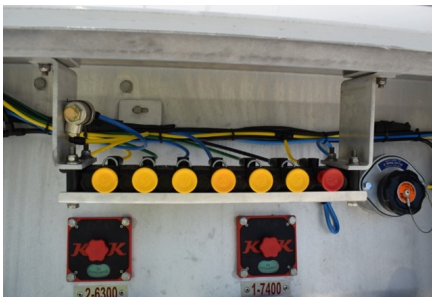
Bloc de commande
