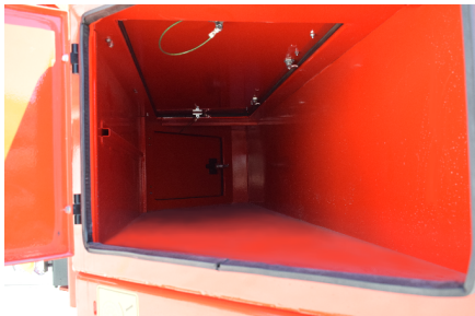
Intérieur de l'armoire
