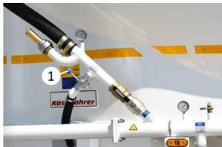
Vanne d'évacuation d'air
