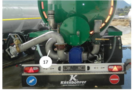
Línea de entrada de la bomba de mezcla de la cisterna
