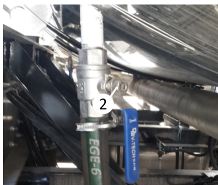
Válvula bajo la cisterna
