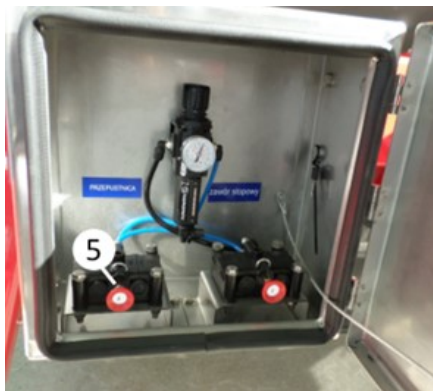
Caja de control neumática
