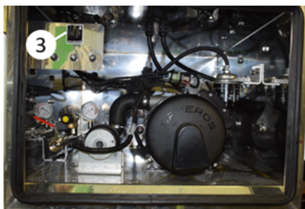
Interruptor dentro del armario
