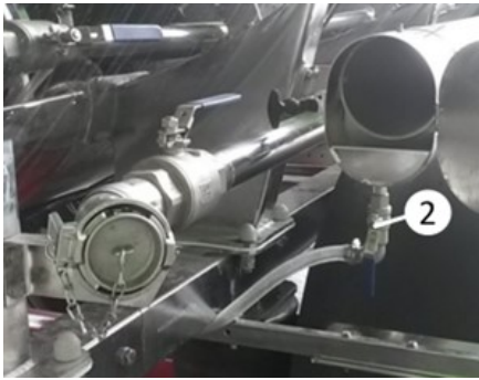
Válvula de drenaje
