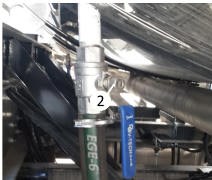
Vanne sous la citerne
