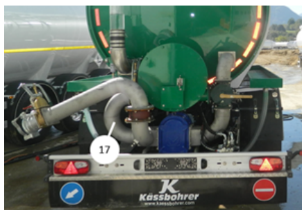
Przewód wlotowy pompy mieszania w zbiorniku
