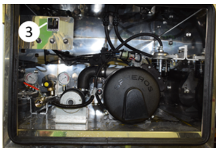
Przełącznik wewnątrz szafy
