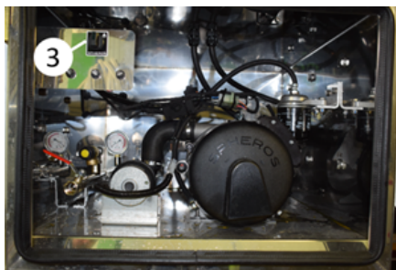
Przełącznik wewnątrz szafy
