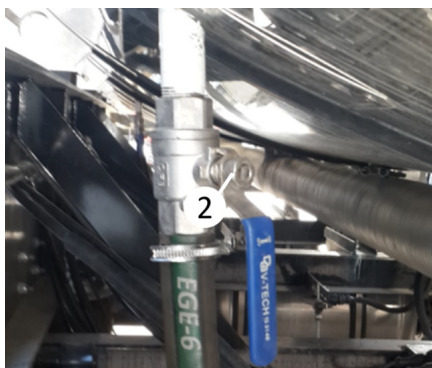
Zawór pod zbiornikiem
