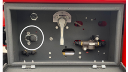
Botón de corcho de elevación del eje en el armario eléctrico
