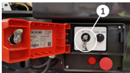
Mise en marche de l'unité de commande
