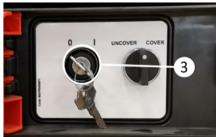
Spegnimento dell'unità di controllo dei teloni
