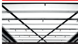
Dachplane mit zusätzlichen Anschlüssen
